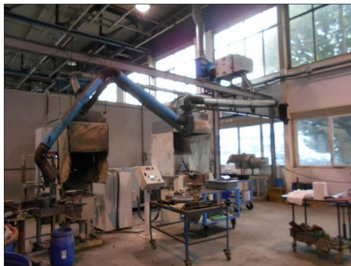
Figure 19 : Prise de vue photographique des fours de fusion
